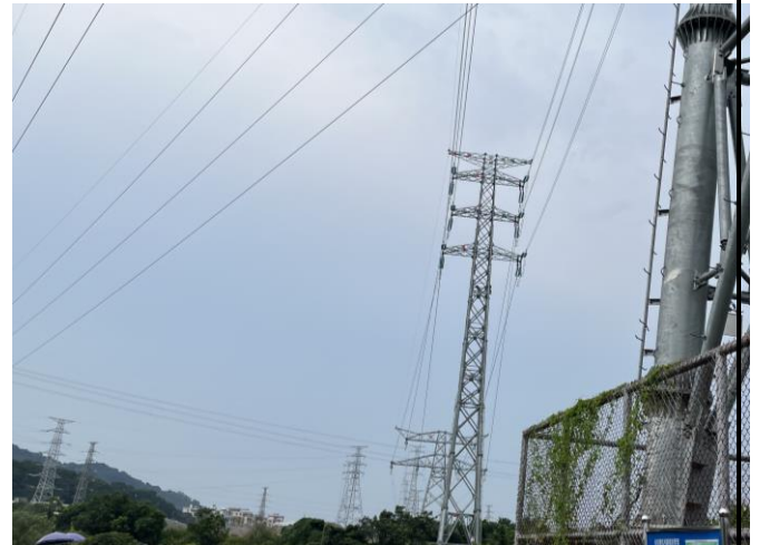
220kV 同塔双回线路
