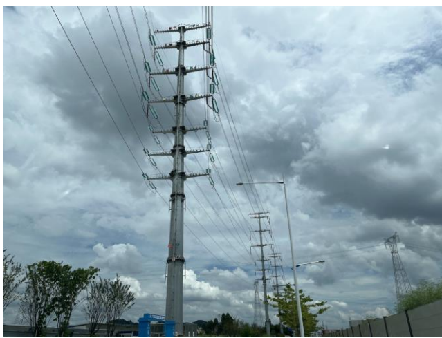
220kV/110kV 混压四回线路
