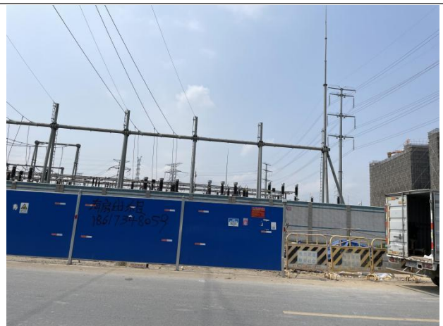
220kV 汉田站扩建间隔侧
